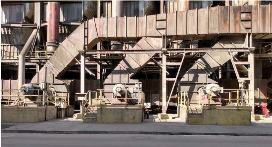
Figura 1: Exaustores da planta tratamento de gases
