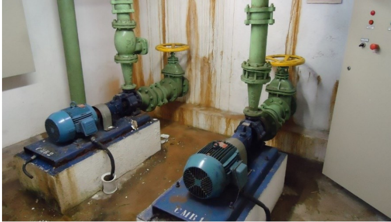
Figura 2 – Conjunto moto bombas
